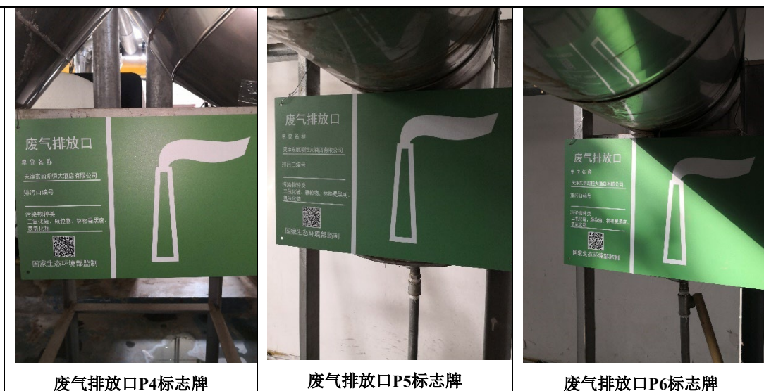
图2-7 废气排放口规范化照片
