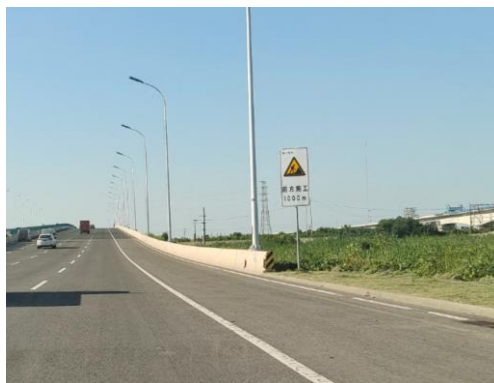
图 18 桥梁护栏未进行端部处理
